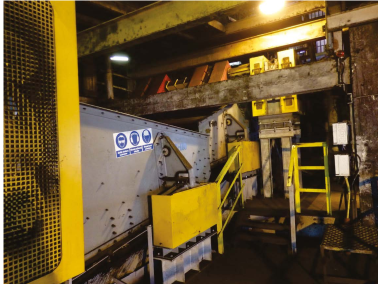
Rys. 5. Zabudowa przesiewaczy PWP1-2,8×5,5 i PWP1-3,0×5,0 w zakładzie
