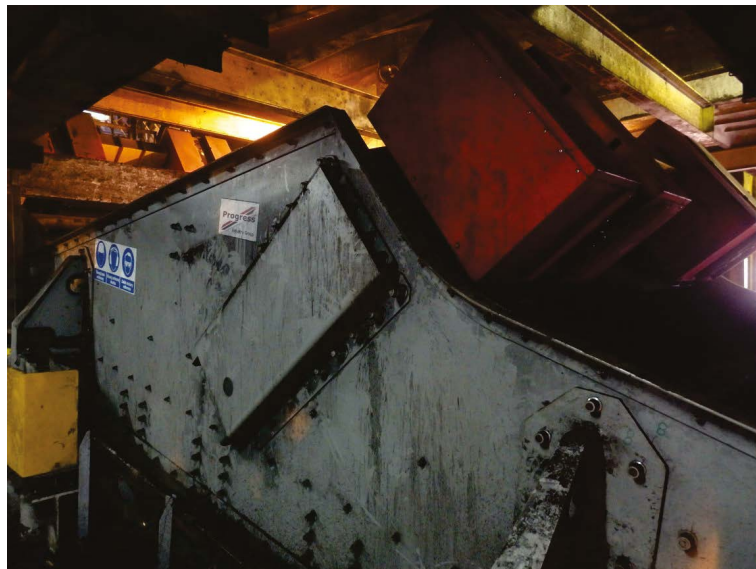
Rys. 6. Zabudowa przesiewaczy PWP1-2,8×5,5 i PWP1-3,0×5,0 w zakładzie
