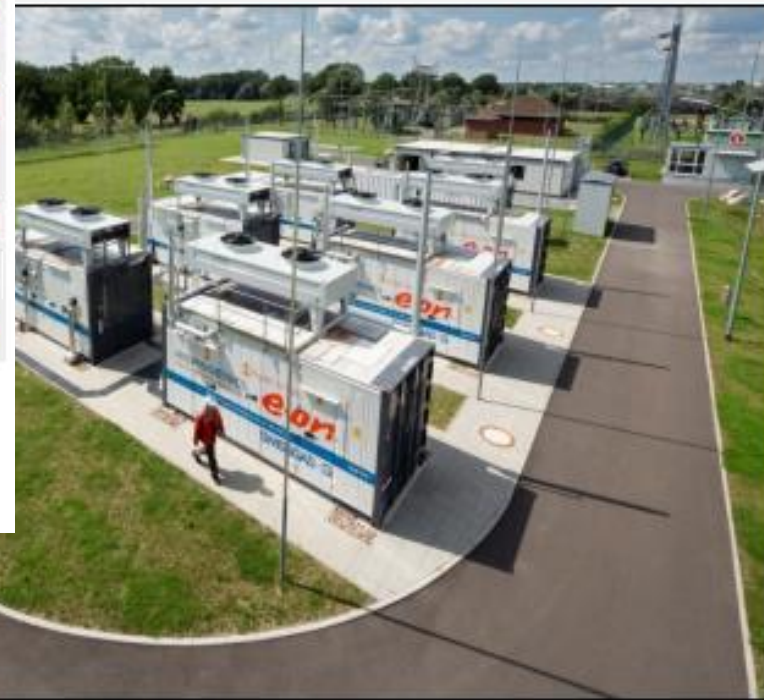
Instalacja Power-to-gas w Falkenhagen, Niemcy (źródło: E.ON), w: M. Chaczykowski, A.J. Osładacz, Technologie power-to-gas w aspekcie współpracy z systemami gazowniczymi , VI Konferencja Naukowo-Techniczna Energetyka Gazowa, 2016
