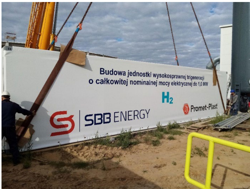
Rys. 2. Prace na placu budowy na terenie Promet-Plast w Gaju Oławskim (opracowanie własne)
